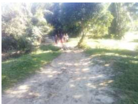
Photo 7 : Piste d'accès - état observé.
